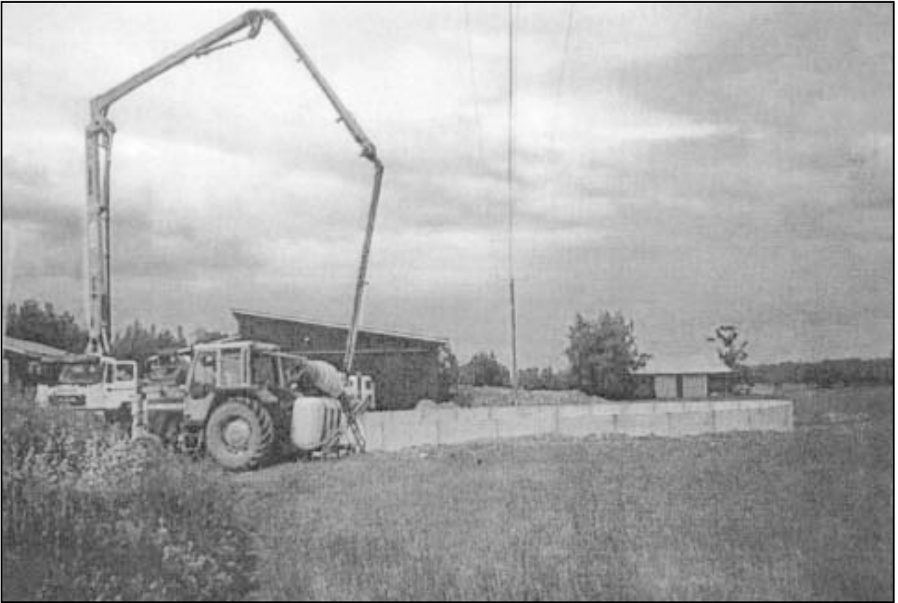
Kuva 1. Kuvan keskellä on lietesäiliön yläreuna, jonka yläpuolella on 20 kV:n ilmajohto ja vasemmalla puolella pumppuauto.
