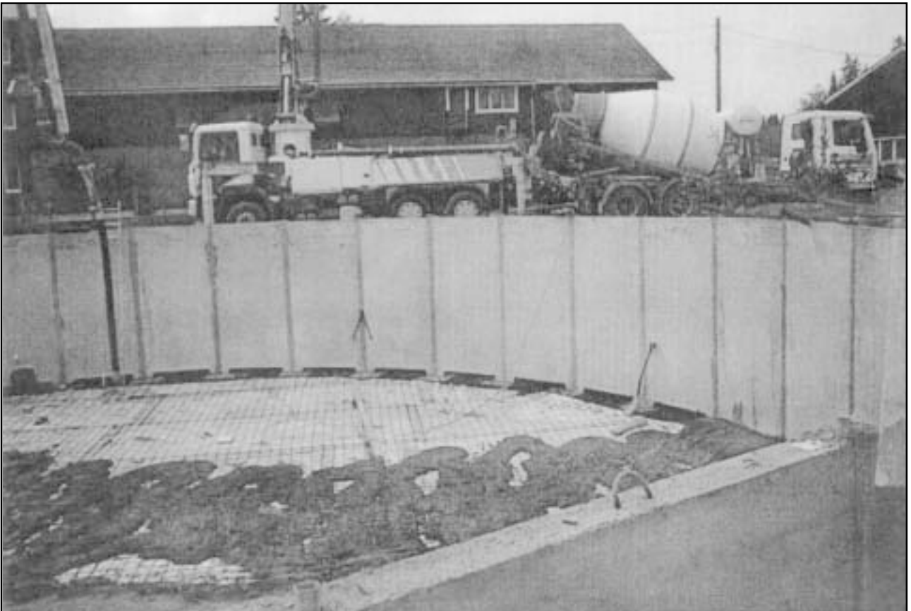
Kuva 2. Lietesäiliön lattian betonityön vaihe tapaturman sattuessa.
