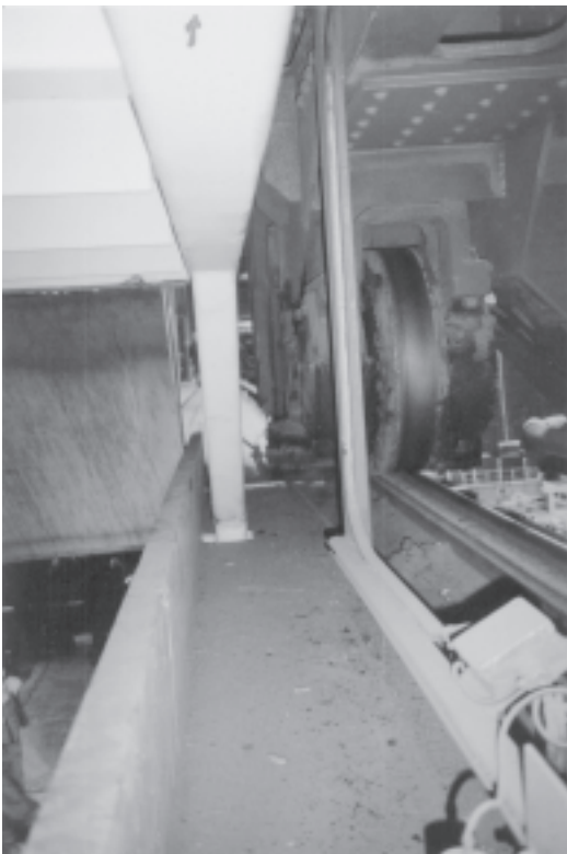
Kuva 1. Kulktasojen välinen aukko, josta oli mahdollista päästä nosturin kulkuradalle.
