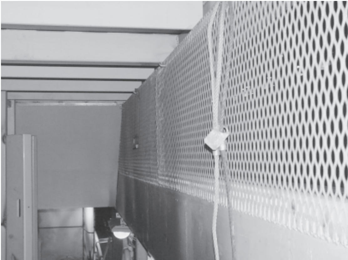
Kuva 3. Tapaturman jälkeen asennettu suojaverkko, joka estää pääsyn kulktasolta siltanosturin kulkuradalle. Taustalla näkyy tapaturmahetkellä asennettu suojapecti.
