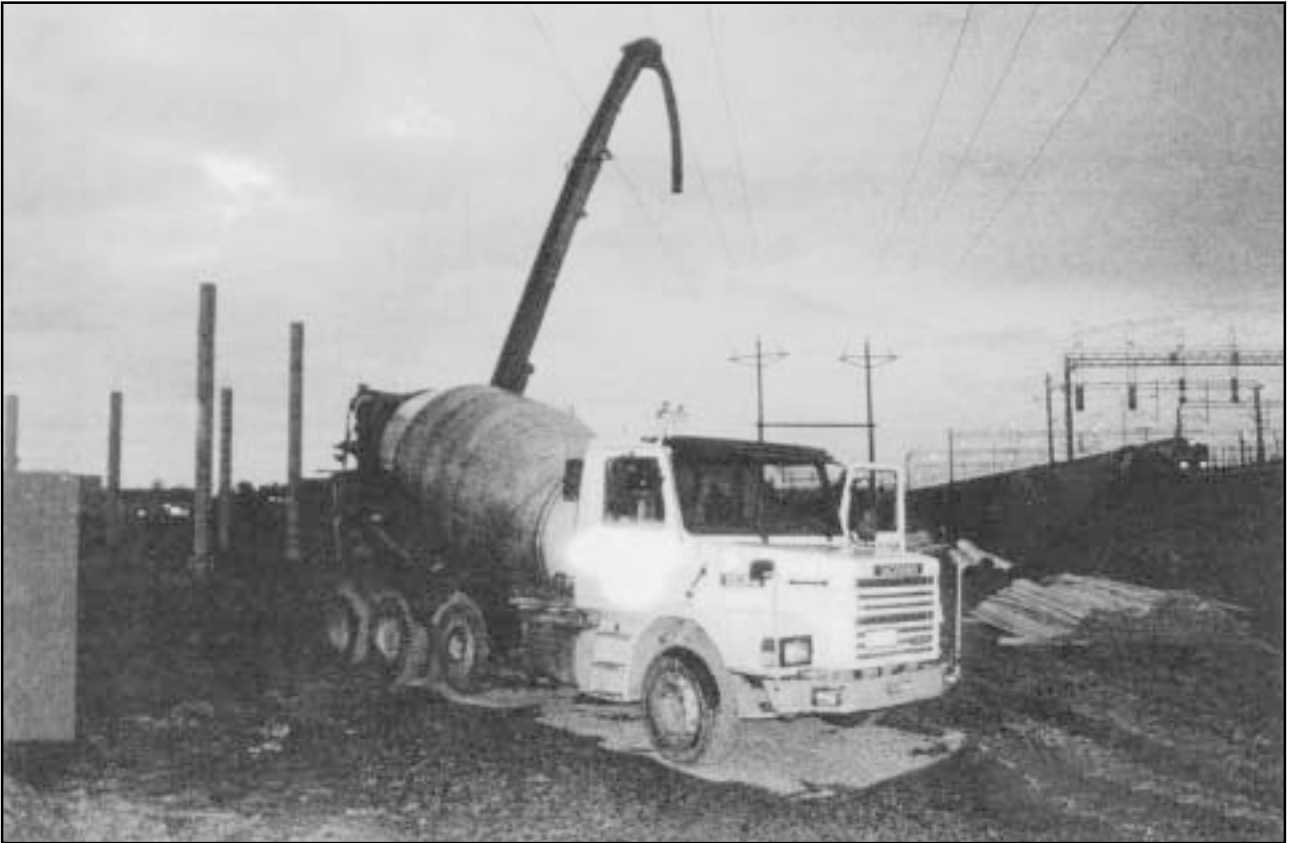
Kuva 1. Kuva autosta ja hihnakuuljettimesta onnettomuuden jälkeen.
