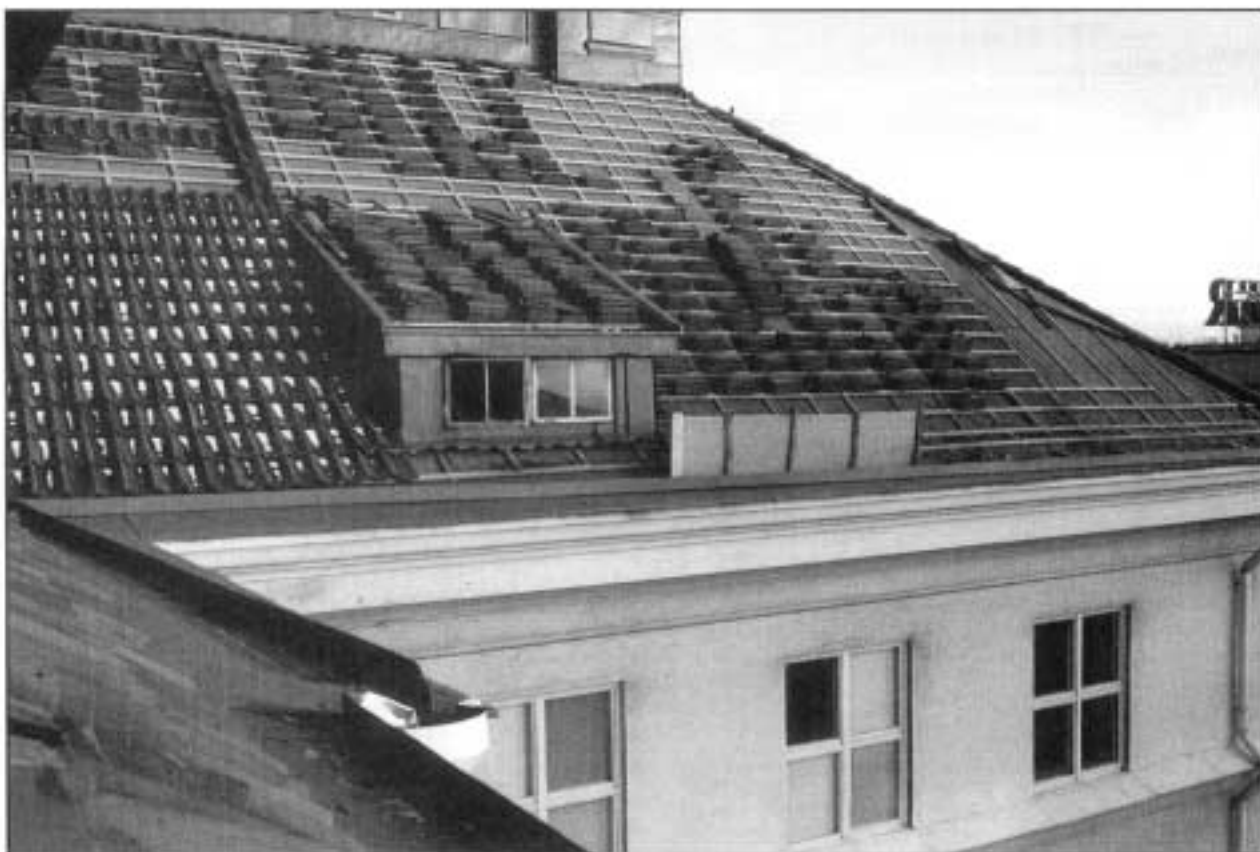
Kuva 3. Vasenta ullakkoikkunaa käytettiin kulkuväylänä.
