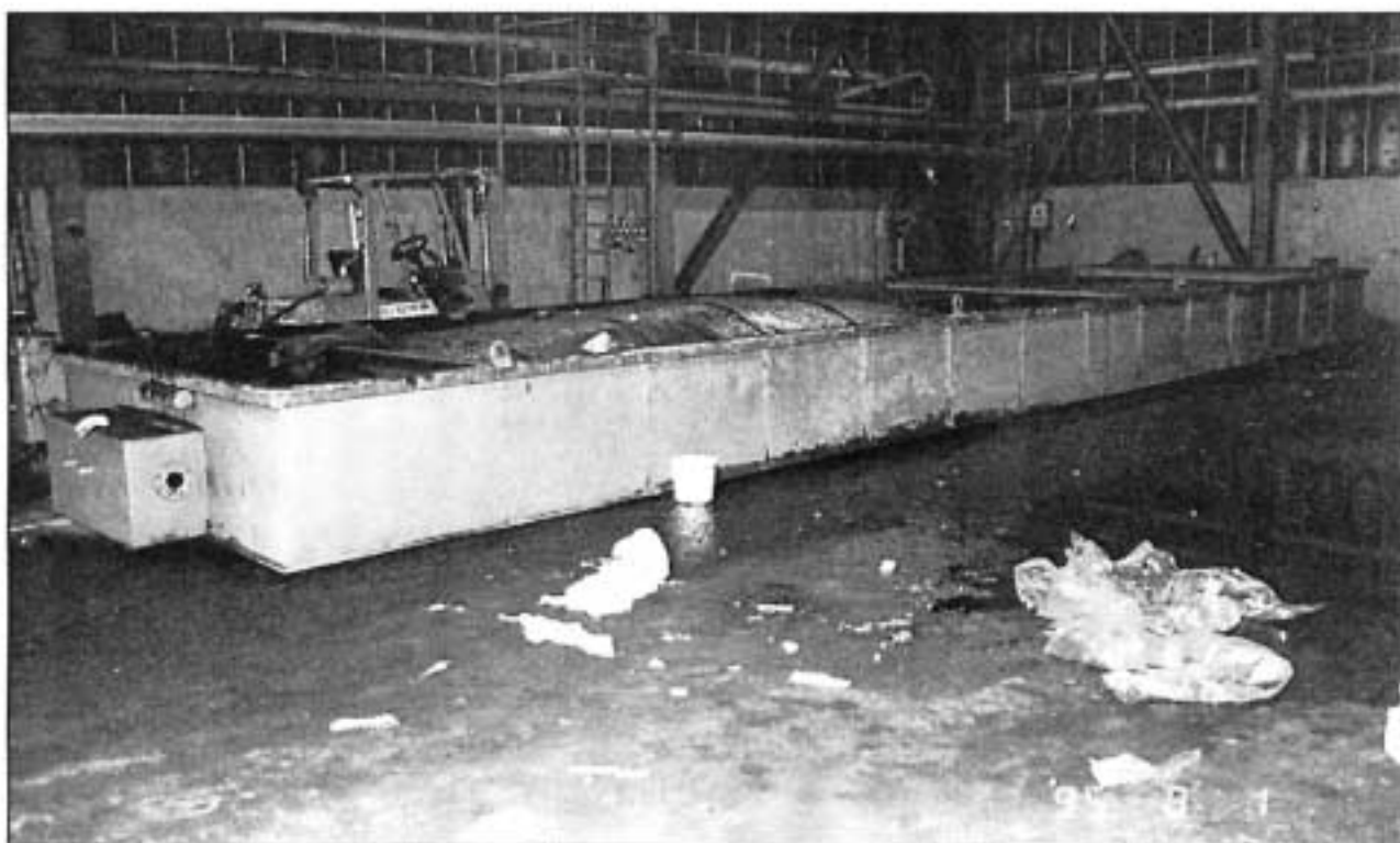
Kuva 2. Kokonaiskuva onnettomuusaltaasta. Etualalla näkyy räjähdyksestä pullistunut nostealtaan kansi. Takana on ehyenä säilynyt altaan osa.
