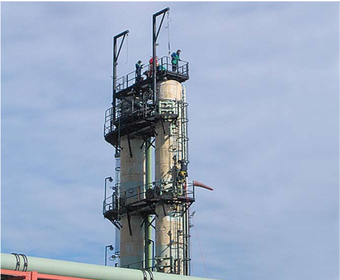
Kuva 1. Tapaturmahetkellä työtä aloitettiin tekemään reaktorin päältä käsin 26,5 metrin korkeudessa.
