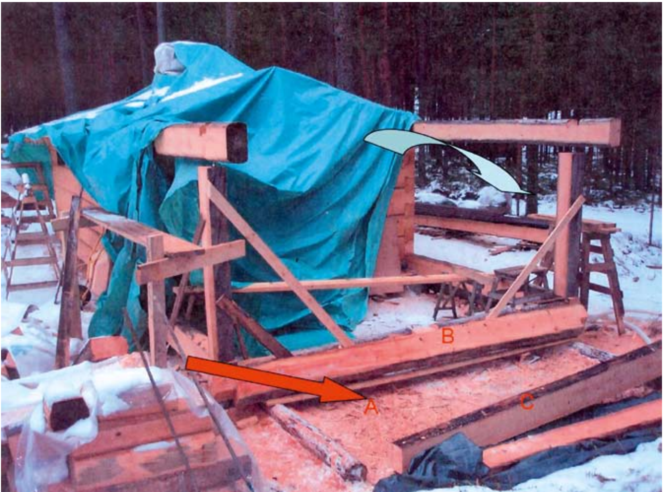
Kuva 1. NN oli kulkenut ylös nostetun palkin alta laskeuduttuaan alas työtelineiltä (punainen nuoli). Samalla palkki putosi alas (kaarinuoli) ja NN:n päälle (kohta A). Yhteen tapitetun palkin osat (B ja C) irtosivat tilanteesta toisistaan.
