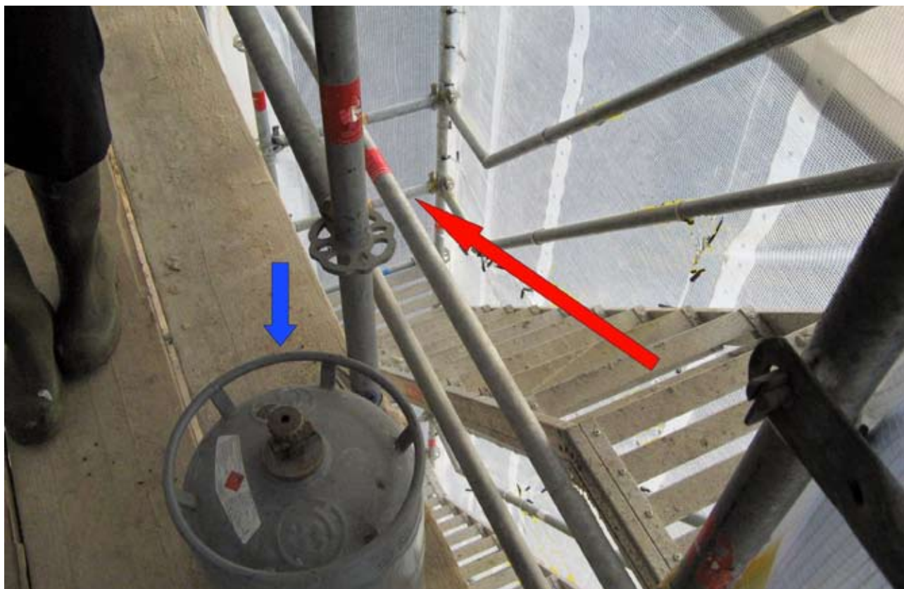
Kuva 2. NN kantoi nestekaasupullon (sininen nuoli) julkisivutelineiden portaita pitkin korjattavan vesikatkon tasolla olevalle työtelineen porrastasanteelle. Laskettuaan pullon alas hän horjahti taaksepäin, ja putosi selkään edellä telineiden alemmalle porrastasanteelle (punainen nuoli).
