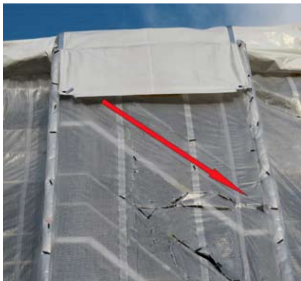
Kuva 1. NN putosi selkään edellä telineiden alemmalle porrastasanteelle, joka oli hieman rakennuksen neljännen kerrostasanteen yläpuolella. NN löi päänsä telinerakenteisiin kuuluvaan poikkitankoon ja telinerakenteisiin kuuluvaan lukituskiilaan.
