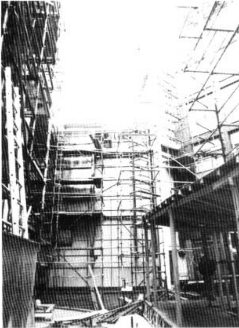
Kuva 1. Torniteline, jota purettaessa tapa- turma sattui ylimmältä tasolta, missä näkyy kaksi työtason osaa.
