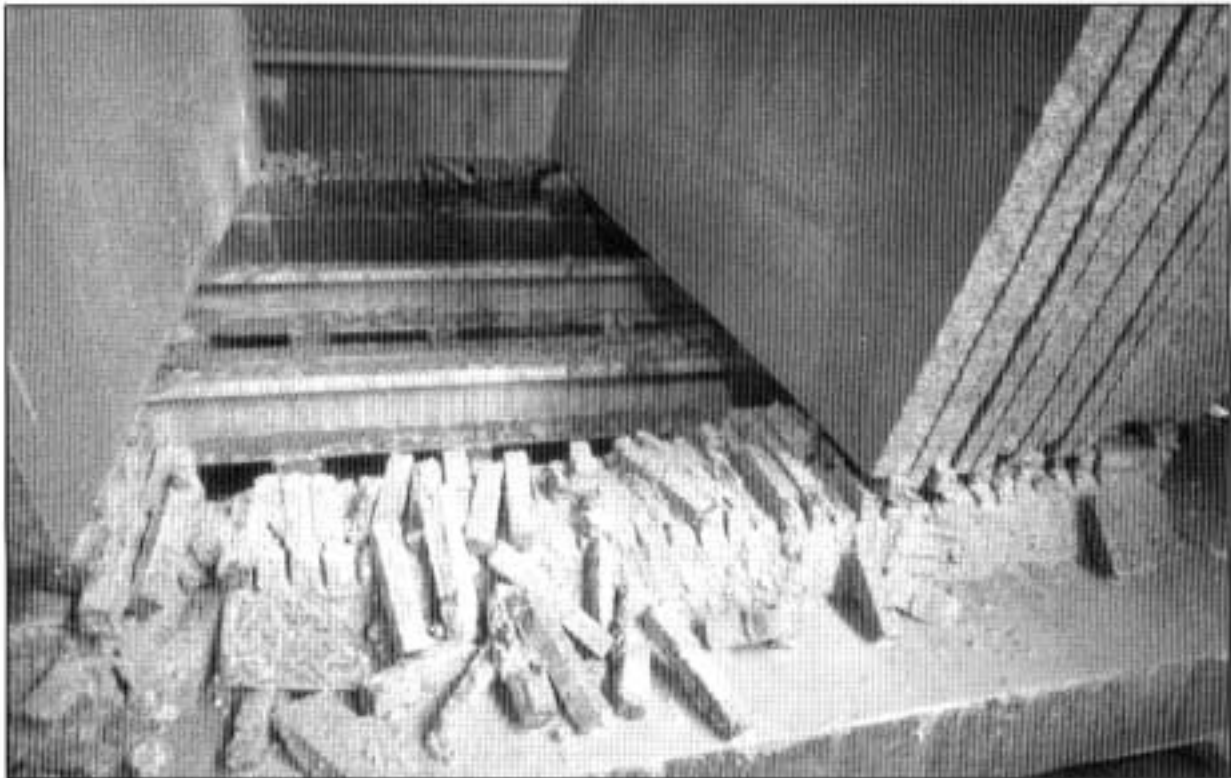
Kuva 3. Kivipeti. Oikealla voi havaita levyjen painumia murtumien seurauksena.
