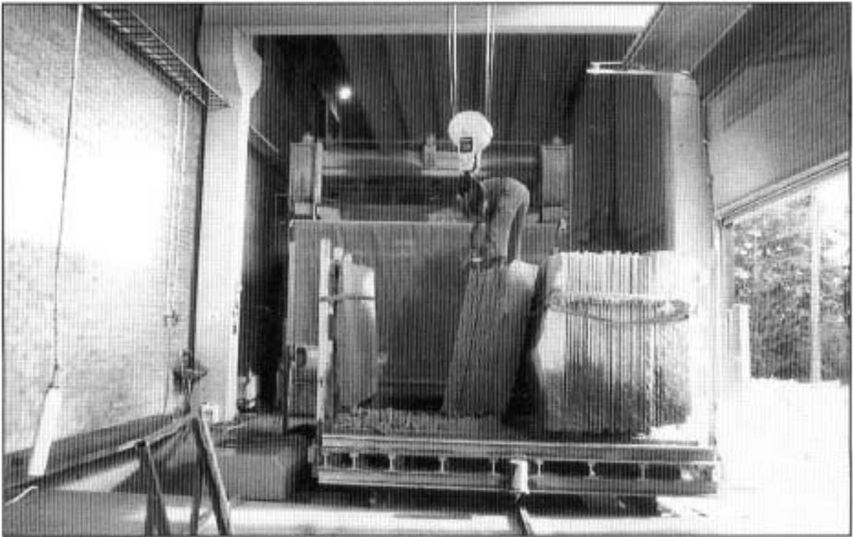
Kuva 1. Työtapaturman sattuessa MN seiso i vaunussa kiinnittäen nostosaksea, kun levyt kaatuivat vasempaan päättyyn. Kuvassa nykyinen työmenetelmä. Toinen sahattu lohkarie sidottu liinoilla.
