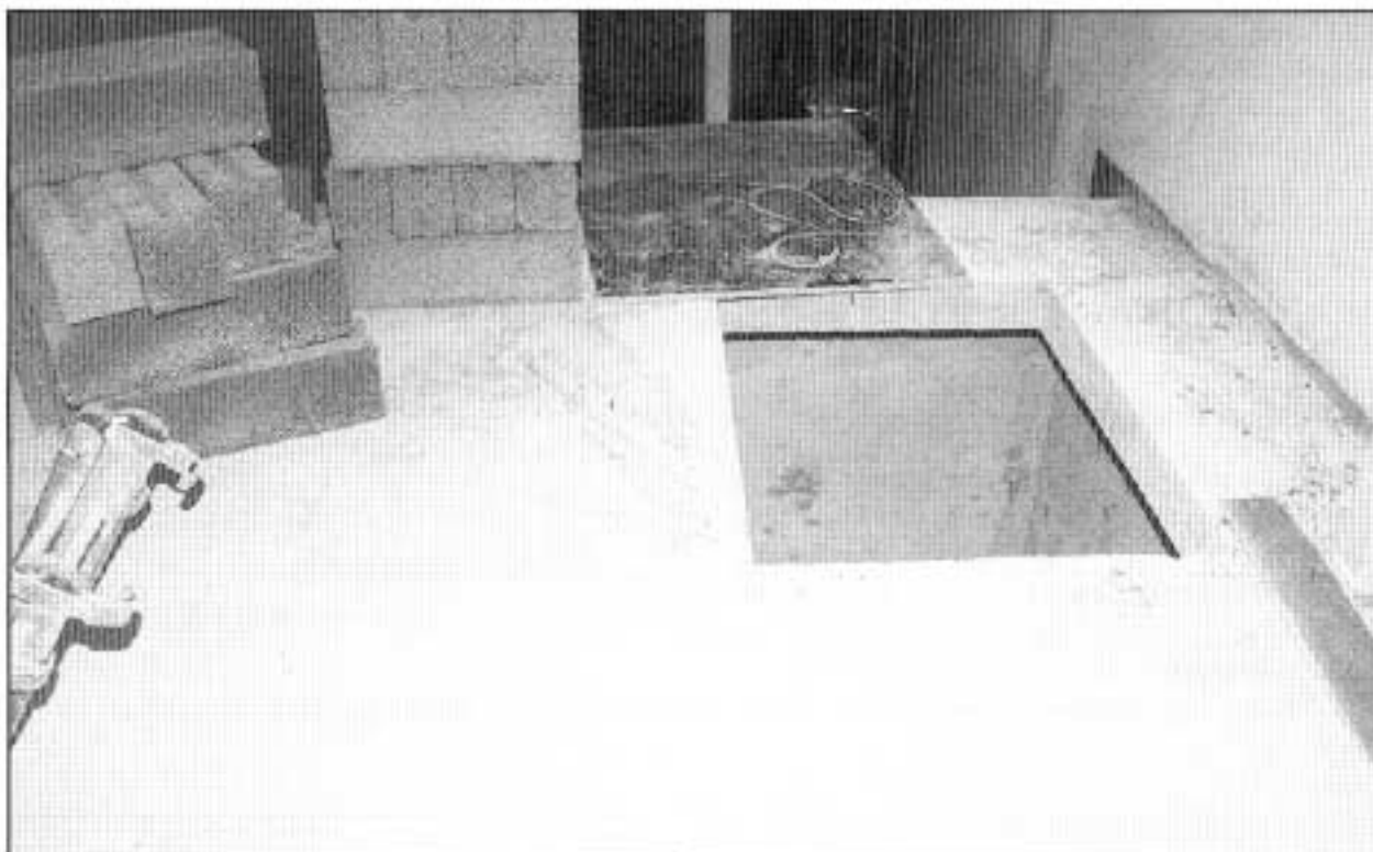
Kuva 3. Aukko, johon MW putosi. Lattialla olevasta pölystä havaitaan suojalevyn olleen vinossa asennossa aukkoon nähden.
