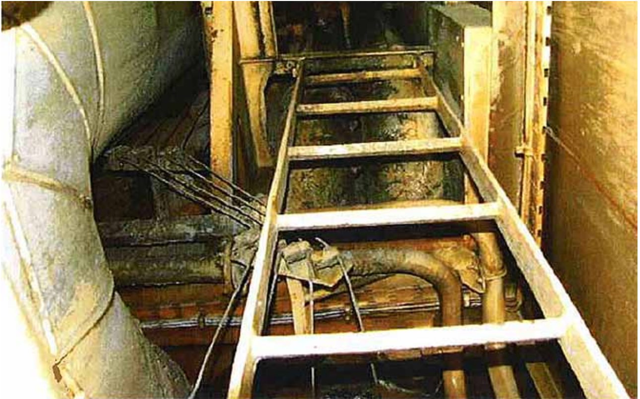
Bild 1. Utsikt från maskinrum till skorstensskaktet. Då fartyget föregående dag lämnat hamnen A märkte maskinreparatör NN att det droppade vatten från skorstensskaktet ner på maskinrumsdurken.
