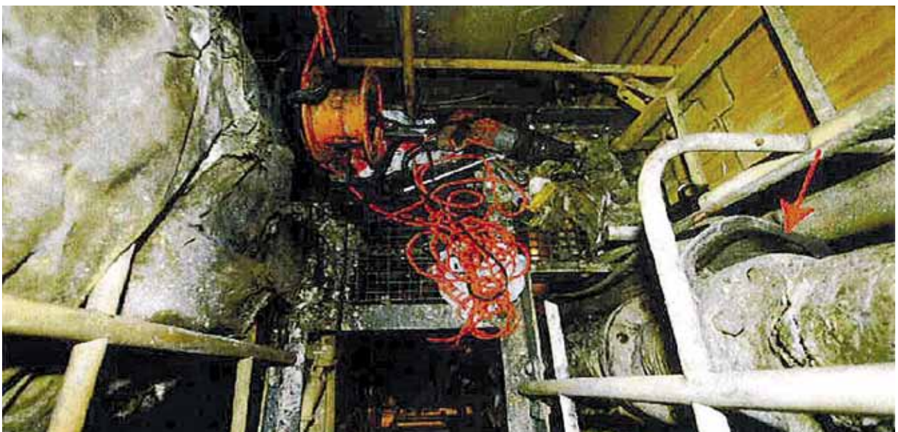
Bild 2. Foto av olycksplatsen. NN hann lösgöra 12 st av kompensators (den röda pilen) 16 bultar, då hett vatten och het ånga började strömma ur röret emot NN.
