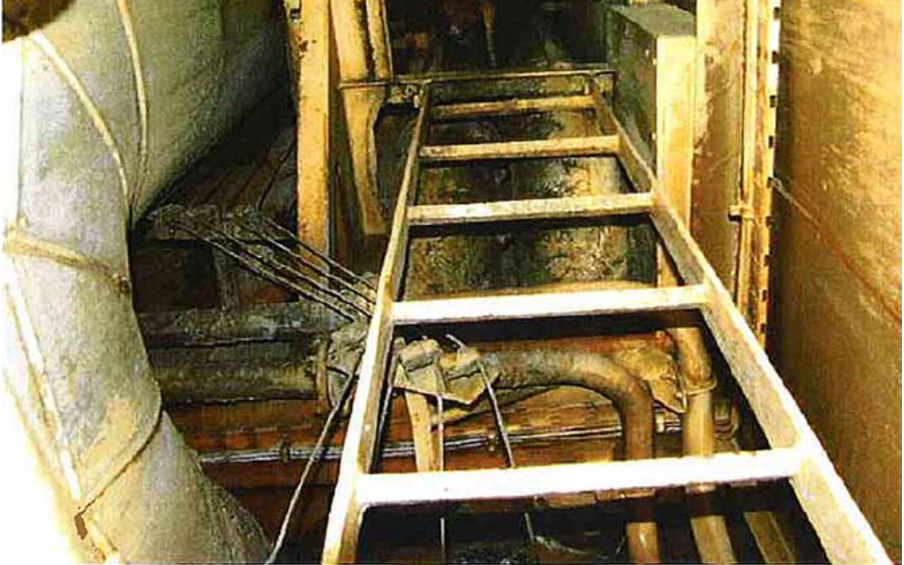
Kuva 1. Aluksen lähdettyä satamasta A aluksen konekorjausmies NN havaitsi, että korsteeniluukusta tippuu vettä konehuoneen lattialle. Näkymä konehuoneesta korsteeniin.
