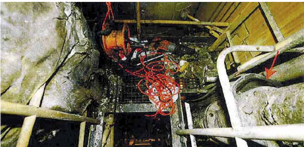
Kuva 2. Kuva onnettomuuspaikalta. NN ennätti irrottaa 12 kpl palkeen 16:sta pultista, kun putkessa ollut kuuma vesi ja vesihöyry alkoi suihkuta päin NN:ää. Punainen nuoli osoittaa paljetta, jota NN oli irrottamassa.
