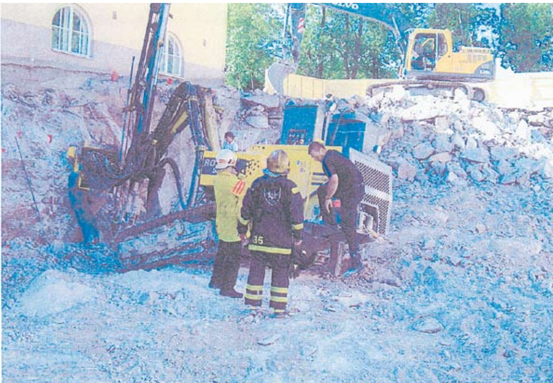
Kuva 2. NN puristui ohjauspaneelin ja kuvan vasemmassa reunassa olevan kallioseinämän väliin.
