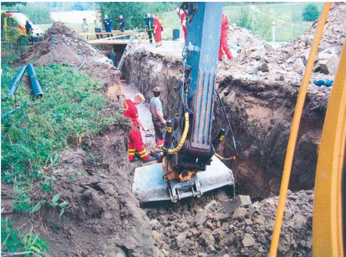
Kuva 2. Kuva tapaturman jälkeen. NN sijoittuu kaivinkoneen kauhan taakse.
