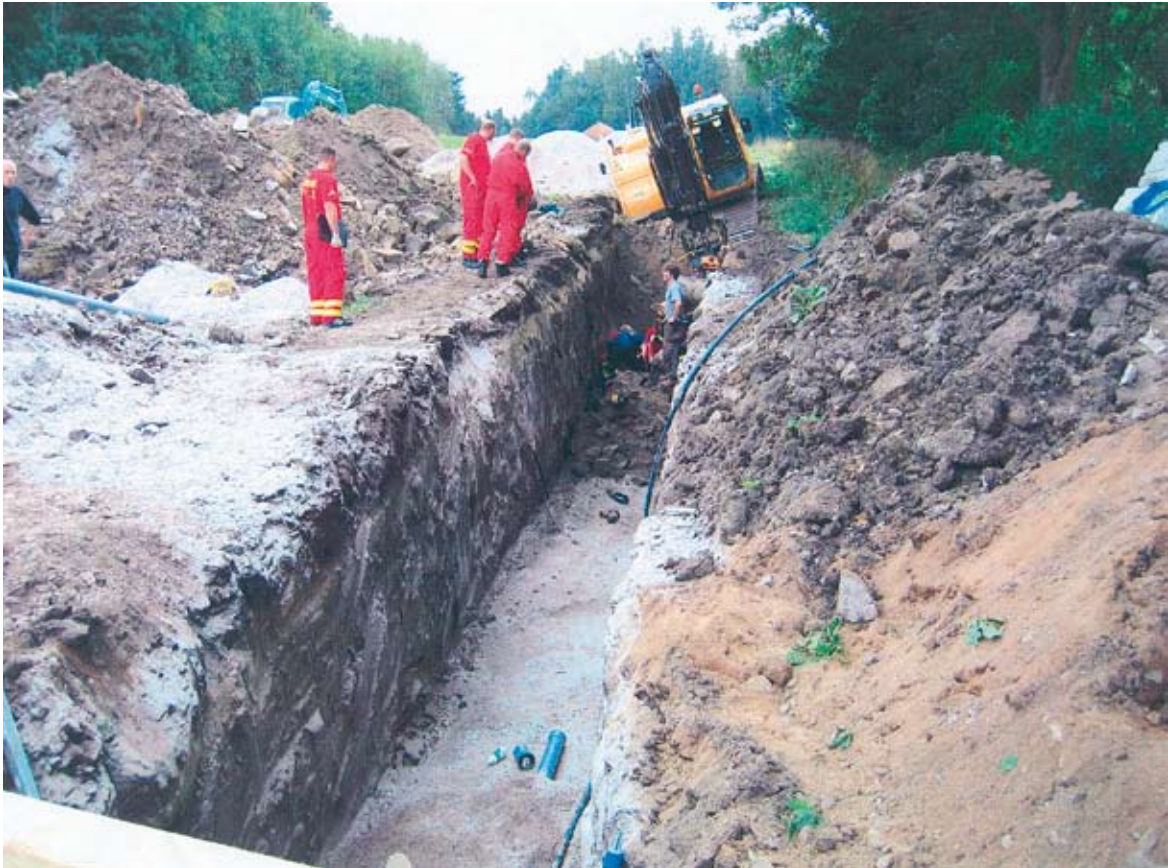
Kuva 1. Yleiskuva tapaturman jälkeen. NN:n pelastustyö on käynnissä. Kaivinkone kallistui pelastustyötavasta johtuen.
