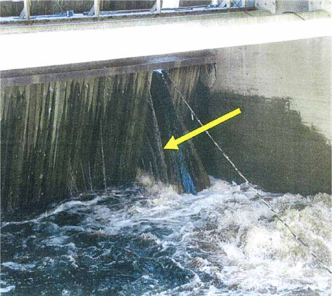
Kuva 2. Onnettomuuspaikka padon toiselta puolelta (alavirran suunnasta) kuvattuna. NN vapautui puristuksesta, kun aukon ympäriltä irrotettiin kaksi muuta parrua ja NN:n turvaköysi ja ilmaletku saatiin irrotettua padon rakenteista.
