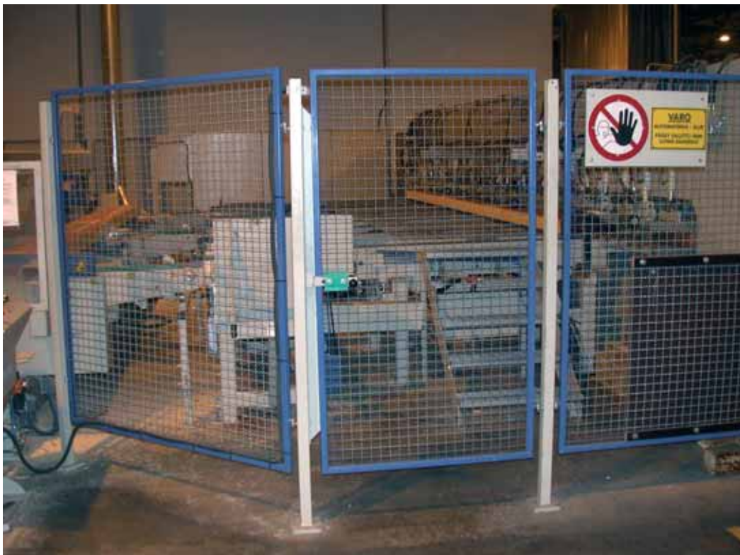
Kuva 2. Käynti koneen vaara-alueelle on mahdollista rajakytkimellä varustetun portin kautta, jolloin koneen toiminnot pysähtyvät automaattisesti.
