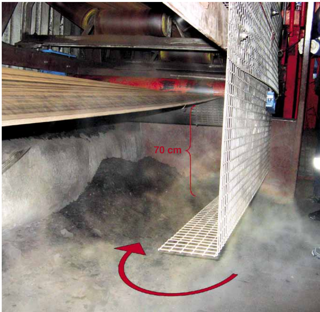
Kuva 1. Hihnan ja hihnatelojen muodostama nielukohta oli suojattu verkolla. Kohteeseen pääsi kuitenkin verkon kiertämällä myös koneen käydessä. Alatelan ja lattian välinen tila on noin 70 cm korkea.
