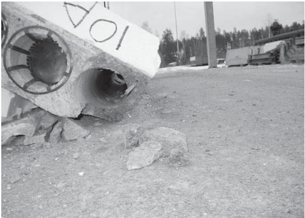
Kuva 2. Päästään ja nostokohdasta murtunut ontelolaatta.
