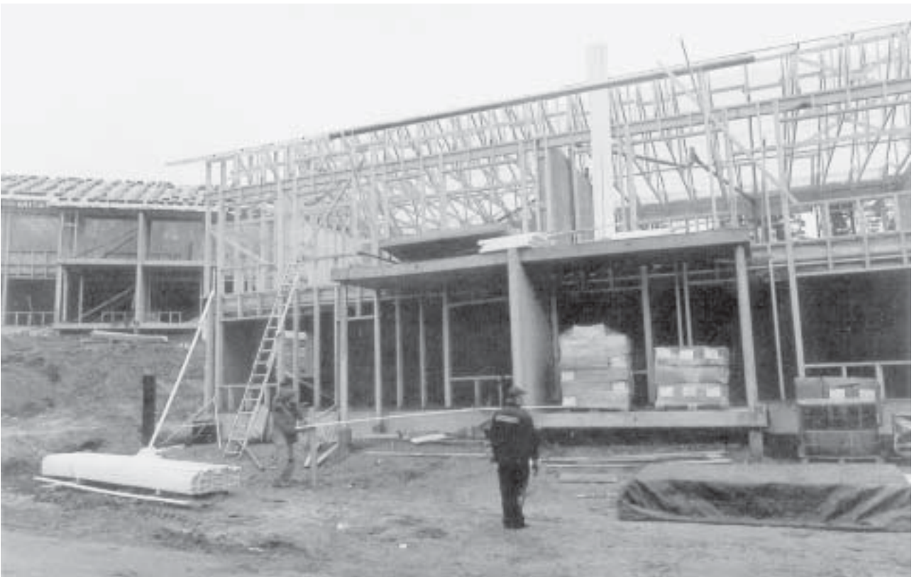
Kuva 2. Tapaturmaparveke, kaatunut elementti.
