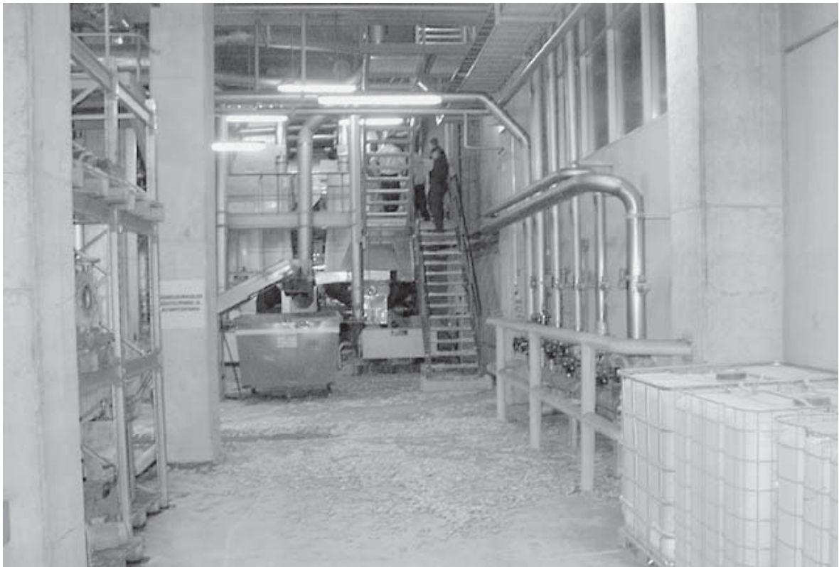
Kuva 5. Yleiskuva tapahtuman jälkeen. Hakepesuri on kuvan keskellä takaseinällä olevalla hoitotasolla. PP meni kuvan vasemmassa laidassa olleen pilarin taakse, välttääkseen ulospurkautunutta haketta.
