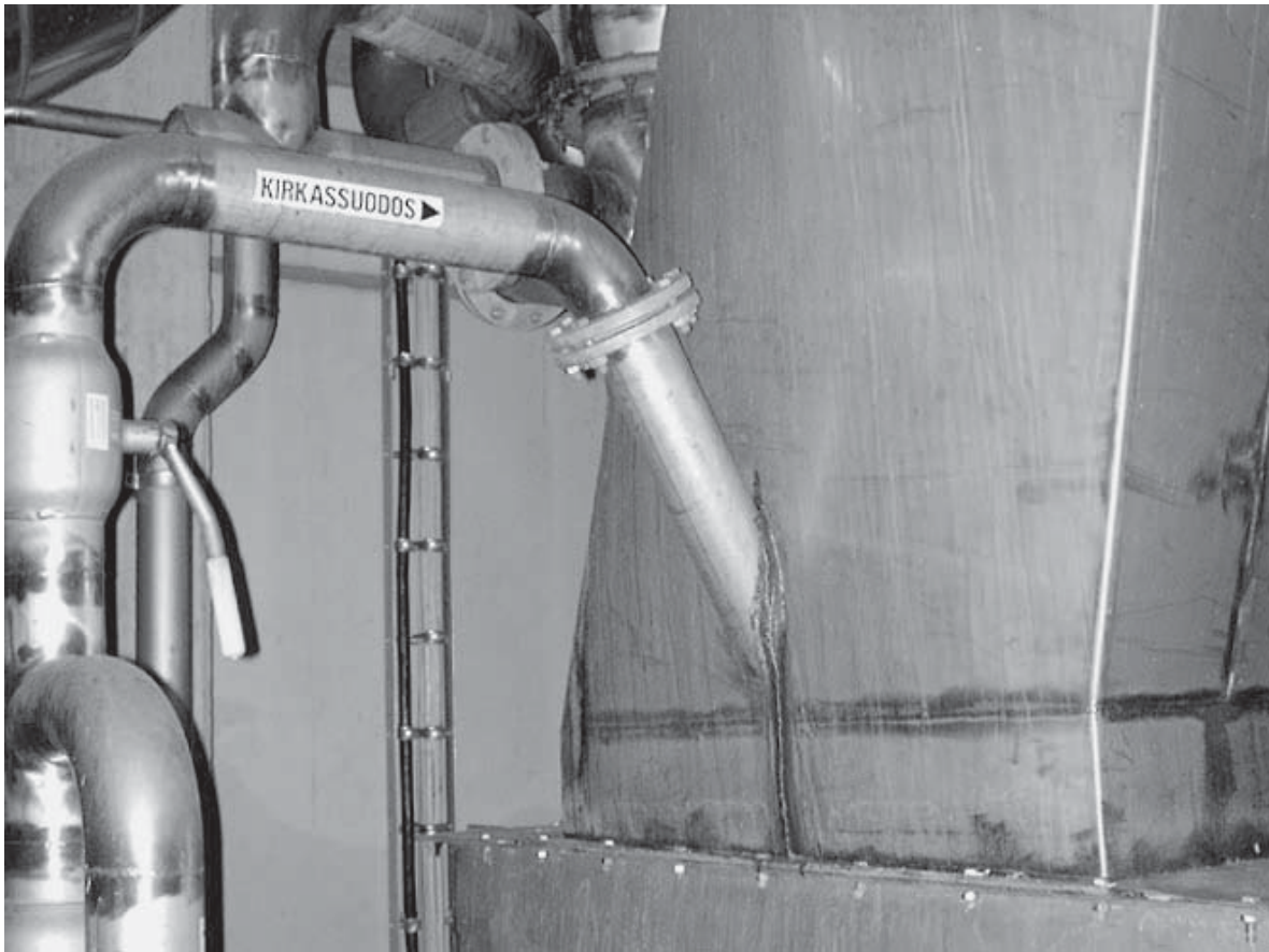
Kuva 6. Kirkassuodosputki pudotustorven kyljessä. Tapaturman aiheuttanut tukkeuma syntyi todennäköisesti kirkassuodosputken ja pudotustorven liitoskohdan alueelle. Pudotustorven alaosassa oleva pieni tukkeutumista myötävaikuttanut mutka näkyy myös kuvassa.
