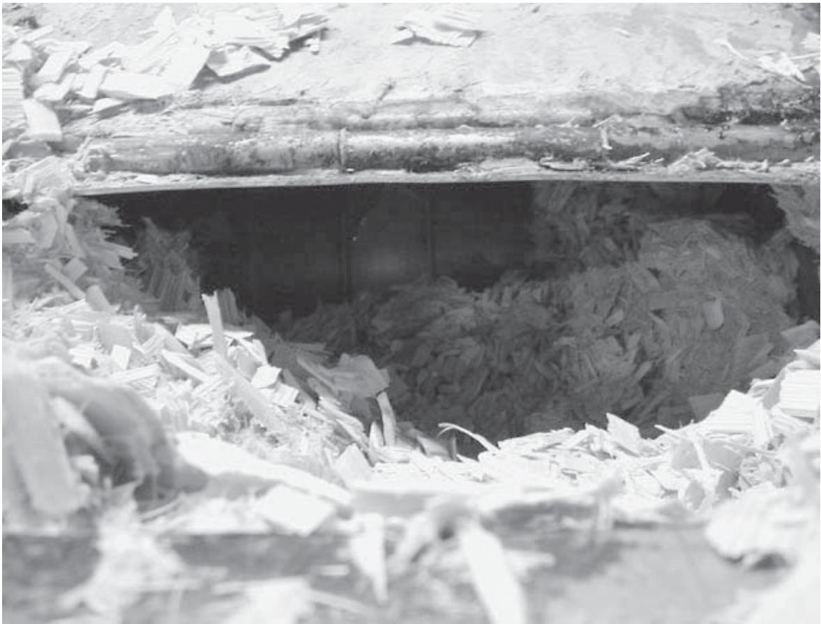
Kuva 4. Hakepesurin kannen kohdalle ulospurkautuneen höyry-vesiseoksen paineesta muodostunut purkautumisaukko.
