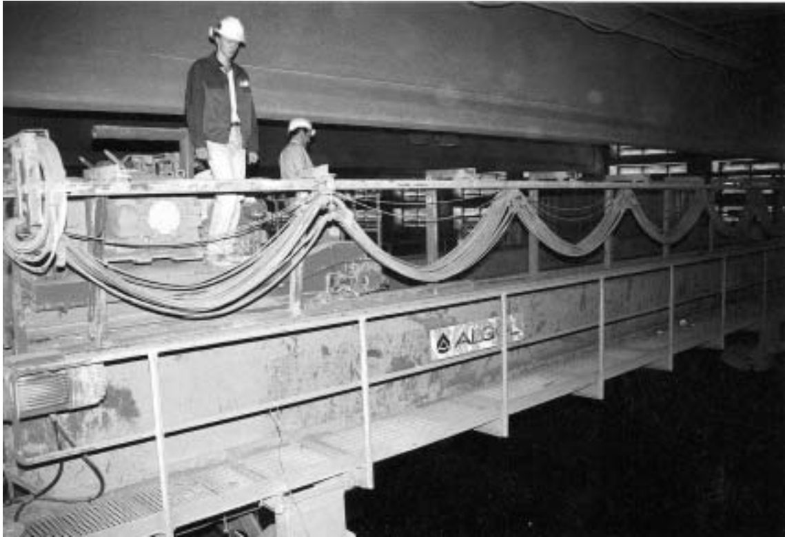
Kuva 3. Siltanosturi takaapäin kuvattuna. NN putosi vaunun päältä 1,4 metrin matkan kuvan keskellä kulkevalle hoitotasolle.
