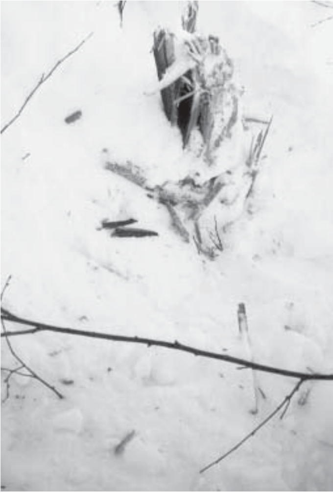
Kuva 3. Pylväs katkesi lumirajasta.
