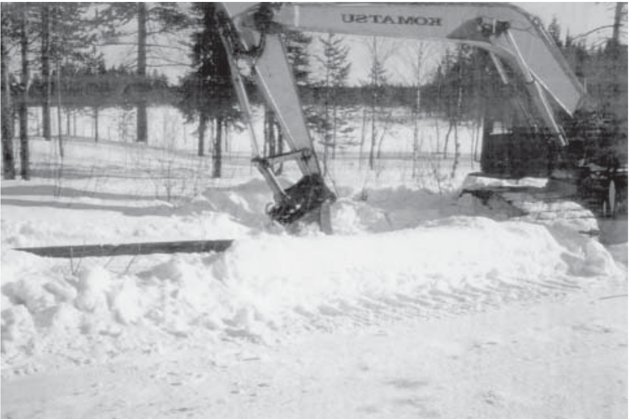
Kuva 1. Kaivinkone. Työtaturmas- sa pylväs kaatui tielle.
