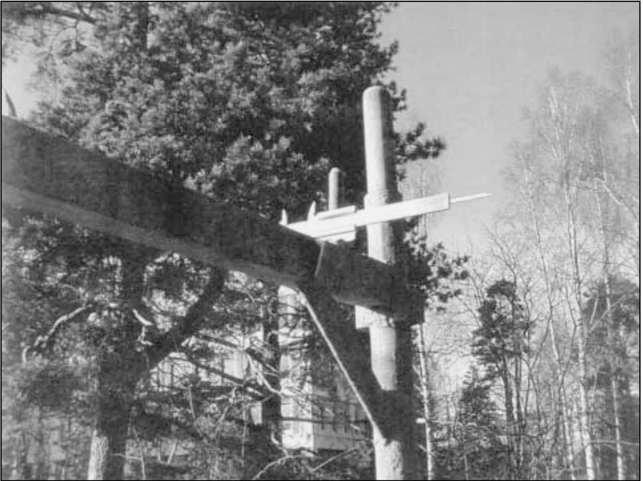
Kuva 2. Työntömitan osoittamassa kohdassa putken yläpinnassa on painaumia, jotka ovat saaneet putken leviämään suurimmillaan 42,1 mm:n mittaan. Muutoin vastaavasti vahvuus samassa putkessa on 36 mm. Työntömitan kohdasta on etäisyyttä pystyputken sisäpintaan 140 mm.
