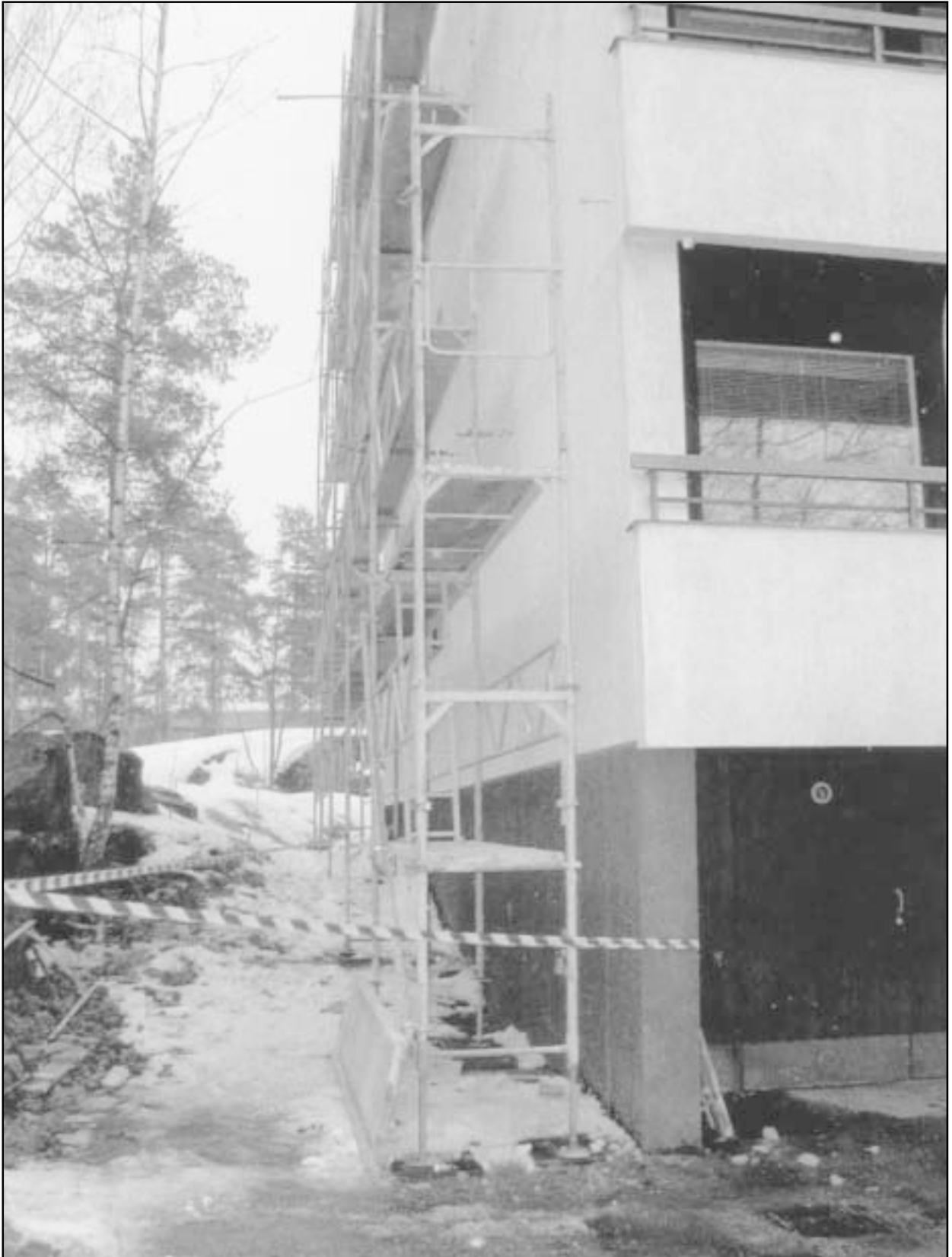
Kuva 1. Taso putosi ja kannatinkorvake katkesi päädyn ylimmän vaakatuen kohdalta.
