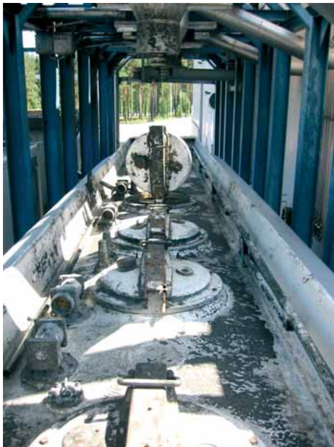
Kuva 2. Näkymä säiliön päältä. Rakenteet hankaloittavat liikkumista säiliön päällä ja aiheuttavat kompastumisvaaran. Tässä tapauksessa em. rakenteita ei voida kuitenkaan pitää välittömänä tapaturmaan johtavana tekijänä.
