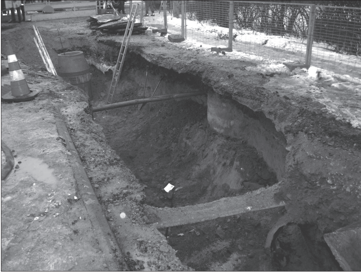
Kuva 1. Kaivannon pystysuora seinämä sortui maanrakennustyöntekijän päälle.
